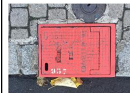
Exemple d'une bouche incendie sur la voie publique à Blois
